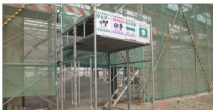
门式外墙脚手架安全通道
